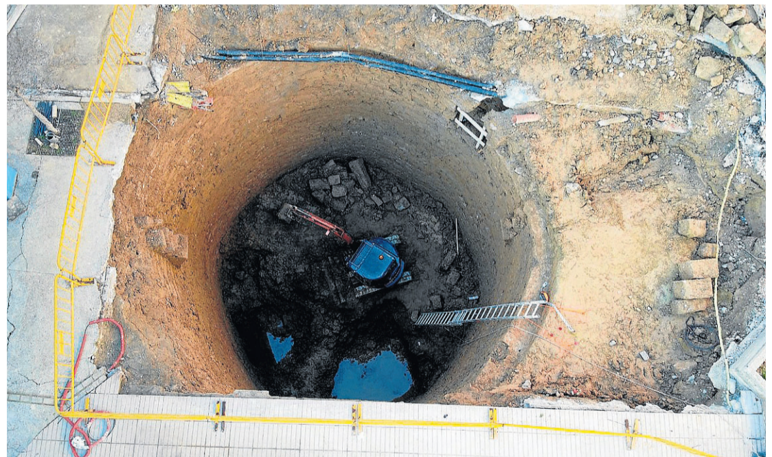
Vista cenital del gran pozo de hielo descubierto por casualidad en Fraga durante unas obras. ATYO. FRAGA
