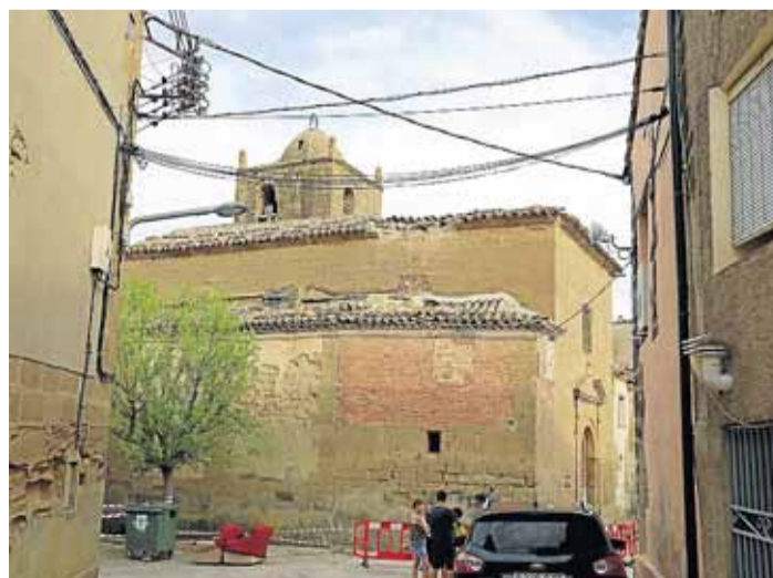
Estado de la iglesia de Barluenga, con el perímetro y su acceso vallados para evitar daños a viandantes.
