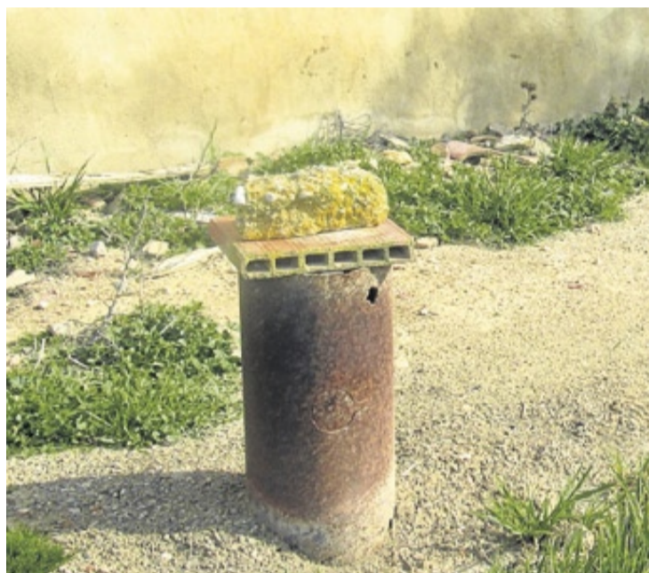
► Un pozo indebidamente tapado con un ladrillo y una piedra.
