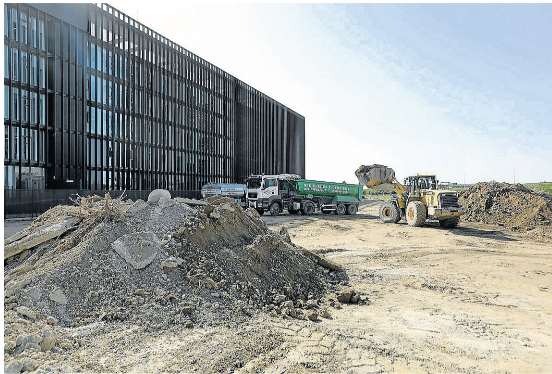
Las máquinas empezaron a desbrozar ayer el solar donde se levantará el nuevo centro de Huesca. R. GOBANTES
