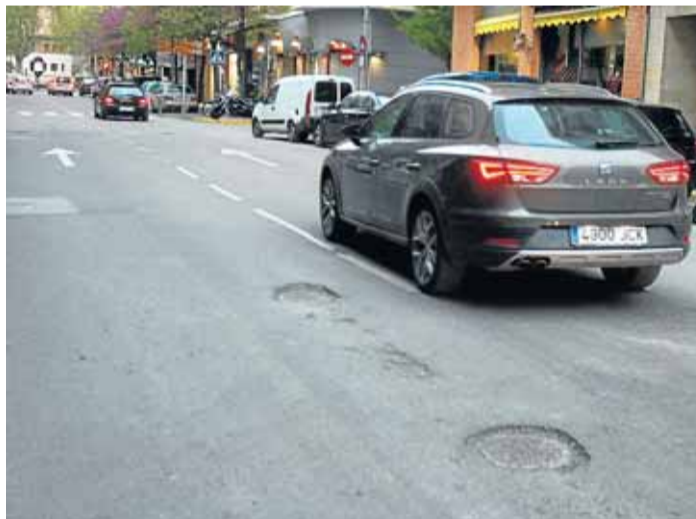
La Asociación de Vecinos se queja de los baches de determinadas calles, como estos de Cabestany, en la foto.
