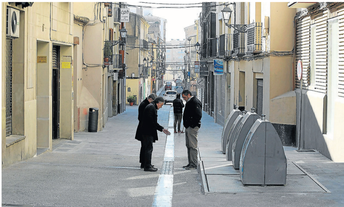
Técnicos municipales y responsables de la obra observan uno de los nuevos sumideros de la calle. R. G.
