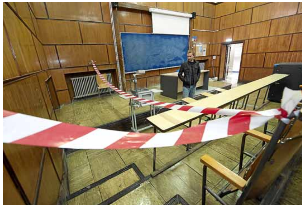
Las goteras se detectaron en el aula 8 de la Facultad de Ciencias. MAITE SANTONJA
